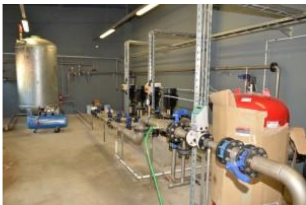
Foto 13. Päre puurkaev-pumpla sisseseade
